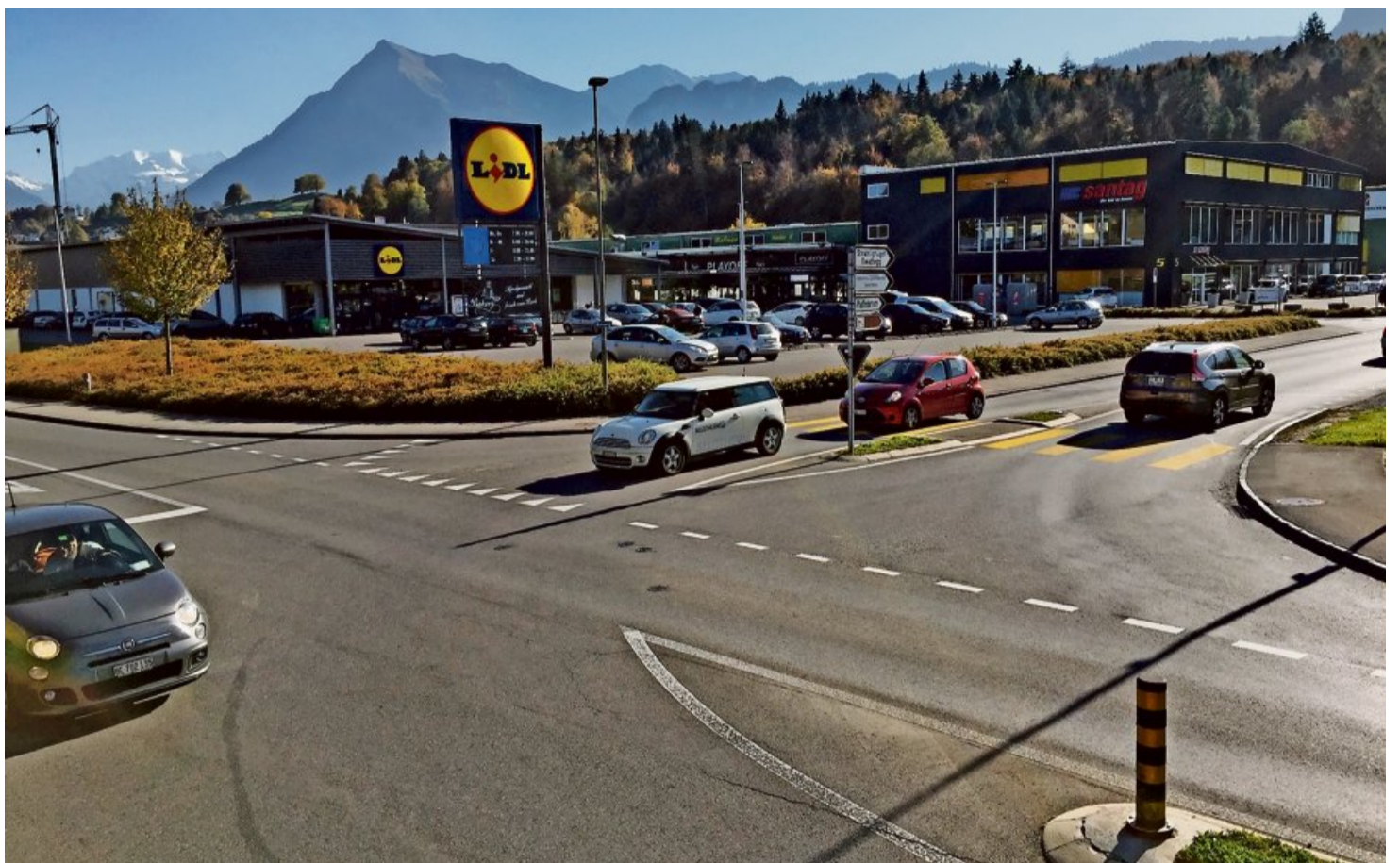
Hier soll bis in einem Jahr ein neuer Kreisel entstehen: Die Einmündung des Mooswegs (rechts) in die Strättligenstrasse.
